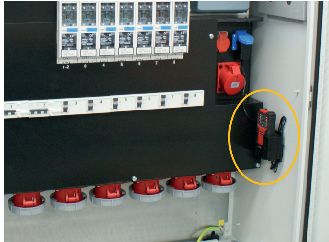
TorchLED Taschenlampe Notlicht in Baustromverteiler
